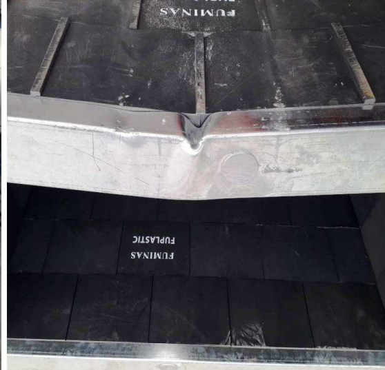
Foto 7: Detalle Deformación de la estructura
