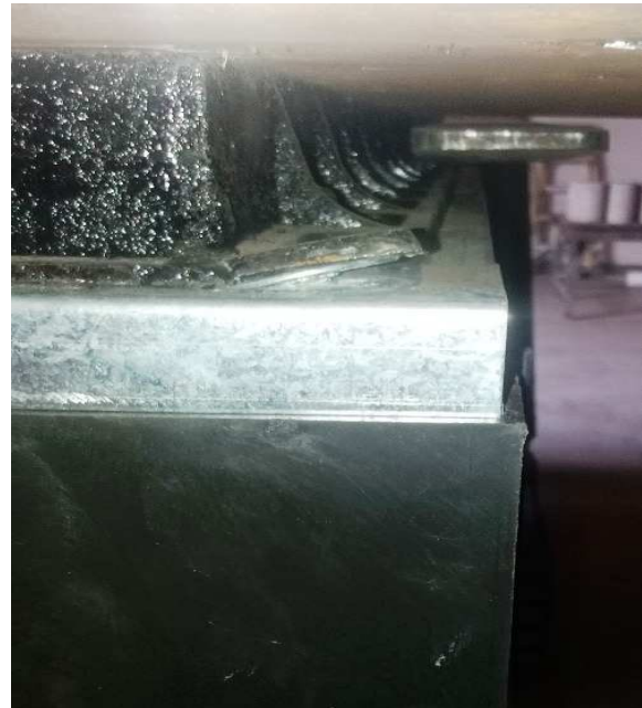
Foto 3: Detalle falla deformación esquina de la tapa
